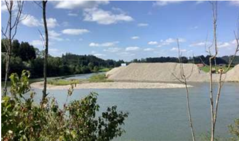
Kiesentnahme im Stauwurzelbereich der Illerstufe 4 Altusried (Kopfspeicher der KEW Kette), Bildnachweis :LEW
